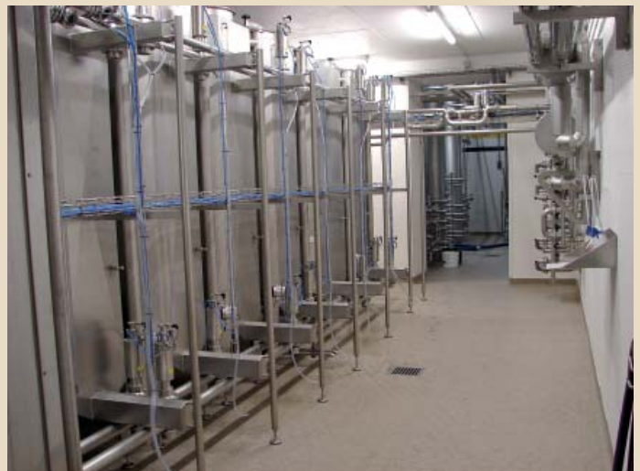
Abb. 4 Ansicht CIP-Anlage komplett
