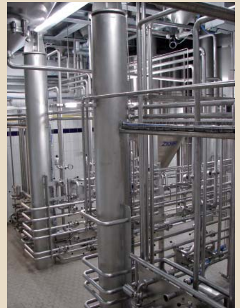
Abb. 2 Sieben Gärtanks und drei Hefelagertanks auf zwei Stahlträgerebenen
