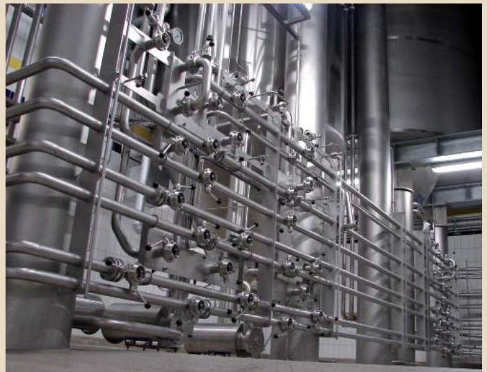
Abb. 3 Gärkellerrohrzaun ohne Bodenkontakt für ideale Kellerreini- gung und Hygiene, aufgehängt an den Edelstahlsäulen der Stahlträger
