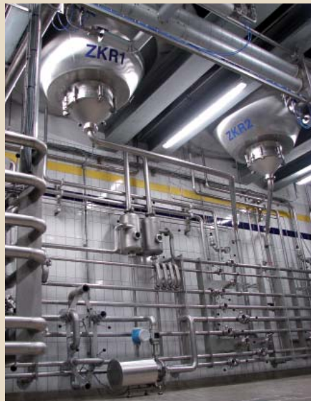
Abb. 6. Reifekeller (v.l.): Paneel zum Umschalten der Fließrichtung der Pumpen, zwei Schaumfallen in CO 2 -Abluft, einmal für untergärig und einmal für obergärig, sowie Reifekellerrohrzaun
